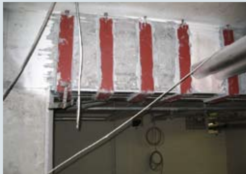
▲ Bild 6: Biegezugverstärkung eines Stahlbetonunterzuges mit oberflächlich aufgeklebten CFK-Lamellen und Stahl-Laschenbügeln
