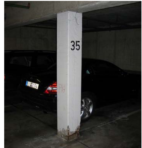
Bild 5: Chloridinduzierte Bewehrungskorrosion in Tiefebene -1
