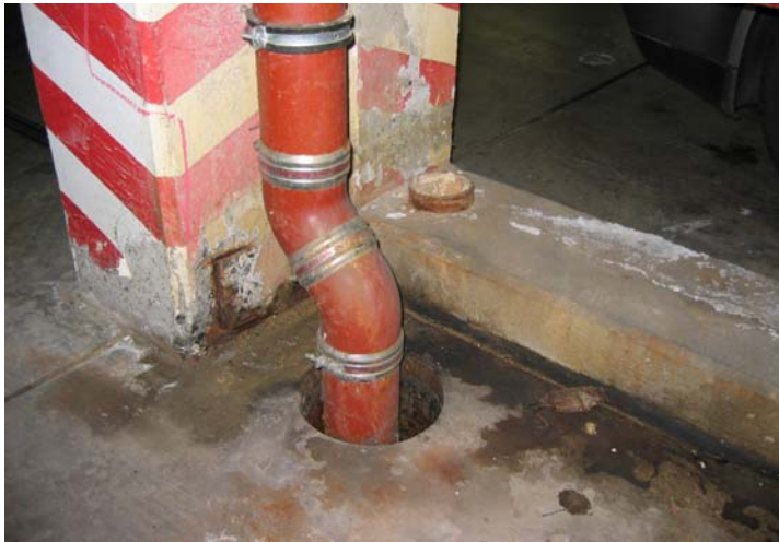
Bild 4: Mangelhaft ausgeführte Leitungsdurchführung
